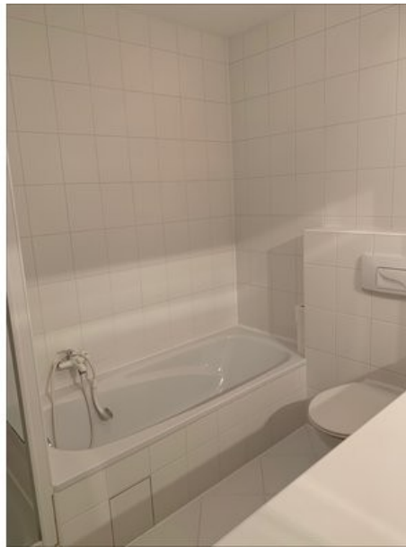
Wanne im gepflegten und belüfteten Bad
